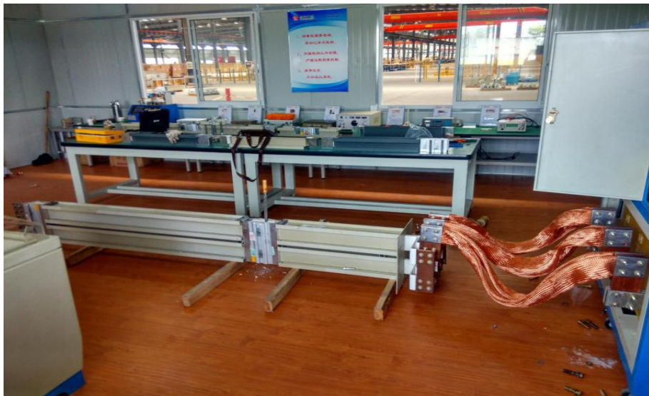
向荣电气现场图片
