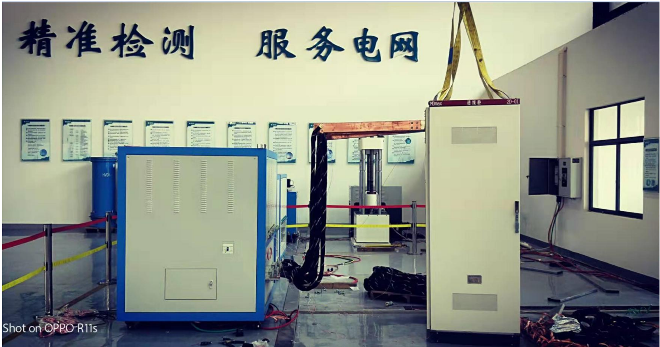
(开关柜温升的图片)
